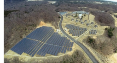
いわき太陽光発電所(全体)
