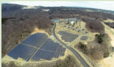
東京不動産管理の創エネ事業「いわき太陽光発電所」増設 → P22
