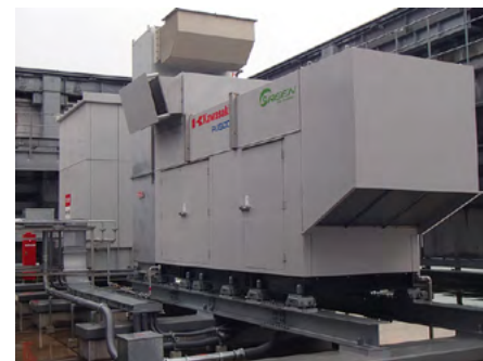
非常用発電機
