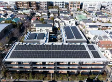
本物件屋上に設置された太陽光パネル
