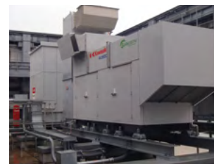
非常用発電機
