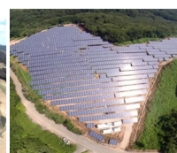
鳩山太陽光発電所
