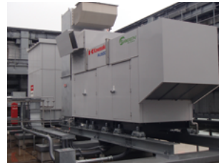
非常用発電機
