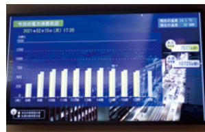
エネルギー使用量のモニター表示
